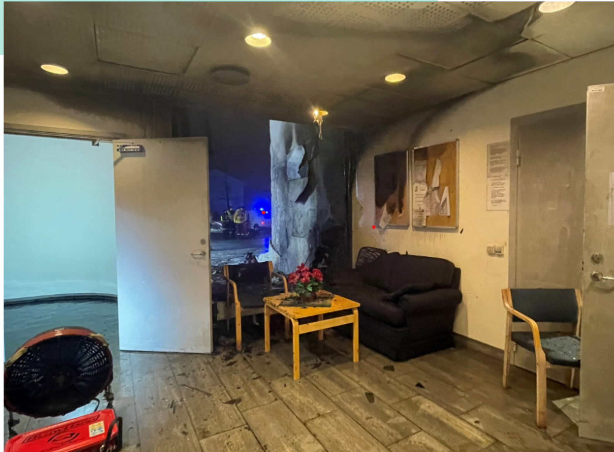
BRANN: Slik så det ut etter at brannen ved bo- og aktivitetssenteret hadde blitt slukket. Foto: Politiet
