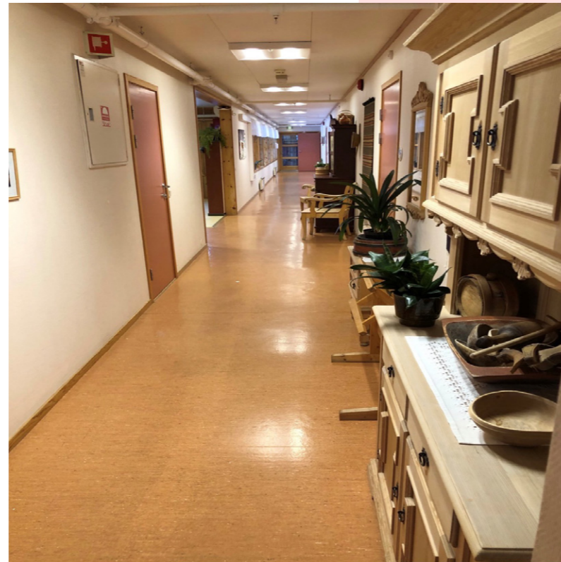
Her har man valgt å møblere på den ene siden av korridoren. Motsatt side vil da være fri i en evakueringsituasjon.
